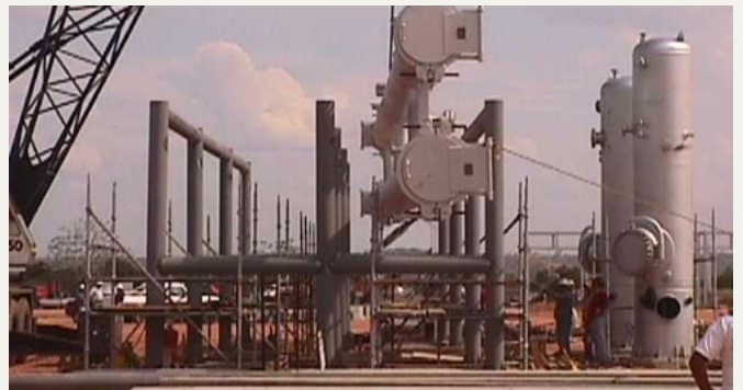
Montaje de componentes industriales
