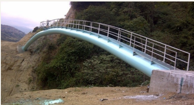
Cruce aéreo de tubería
