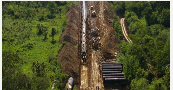
Corredor de tubería
